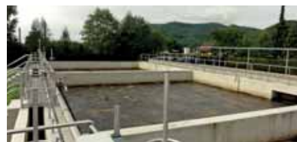
Čistírna odpadních vod ve Velkých Losinách prošla v minulých letech rekonstrukcí
